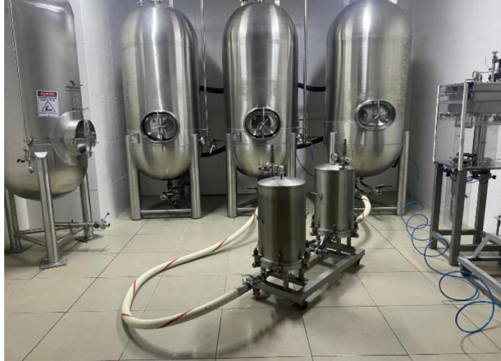
Figura 13: Área de filtração em operação.
