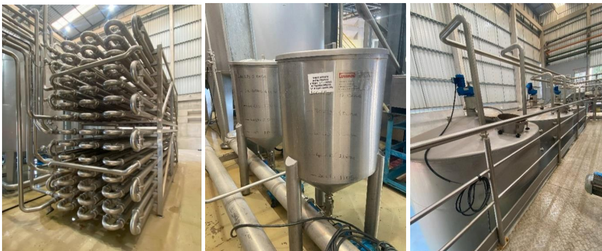
Figura 16, 17 e 18. Trocador de calor tubular, tanques dosadores 1 e tanques com agitador vertical.
