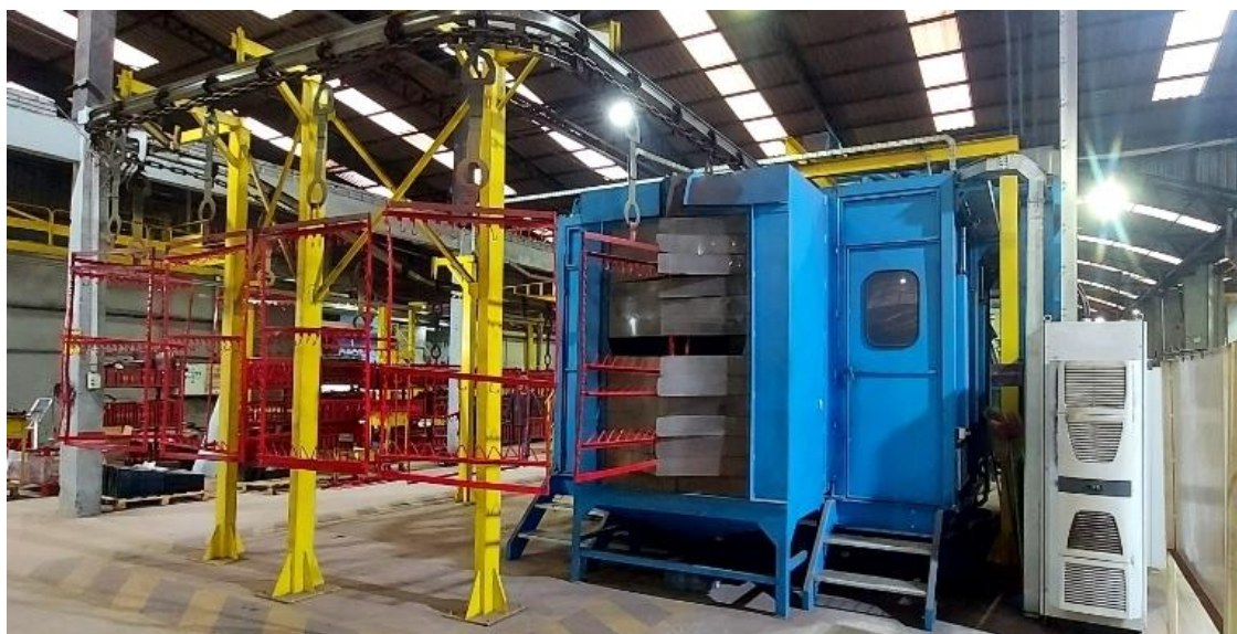
Figura 26 - Linha de pintura.
