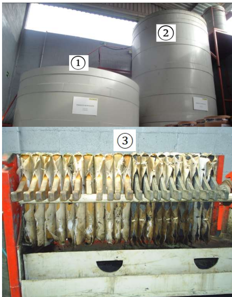
Figura 14 – Tanques ETE da Empresa Estudada. Tanque de Recebimento (1), tanque de separação (2) e filtro prensa (3).
