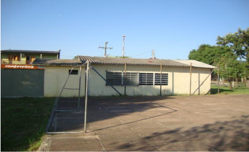
Figura 32. Quadra individual de futsal sem cobertura Fonte: Autor, 2016
