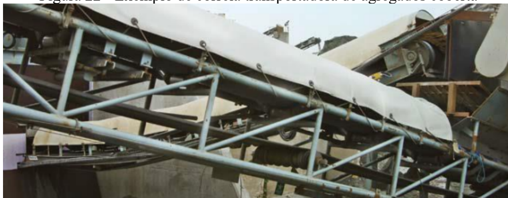
Figura 22 - Exemplo de correia transportadora de agregados coberta
