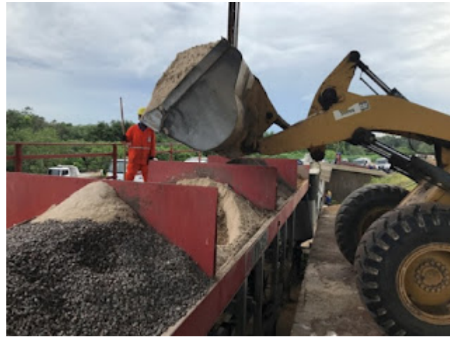
Figura 10 - Abastecimento do processo em usinas volumétricas
