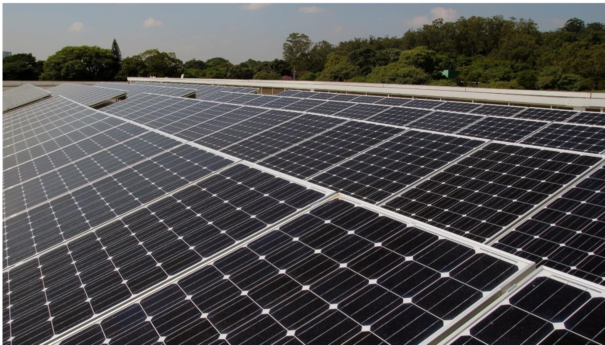
Figura 14 - Painéis solares (Fonte: Universidade de São Paulo, 2014)
