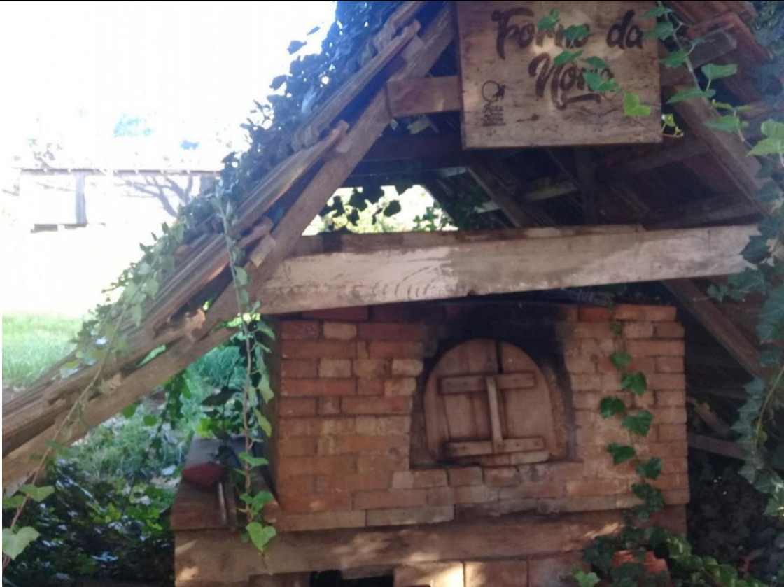
Figuras 23 e 24 – Imagem do forno a lenha que compõe o ponto turístico com avarias e necessitando reforma.
