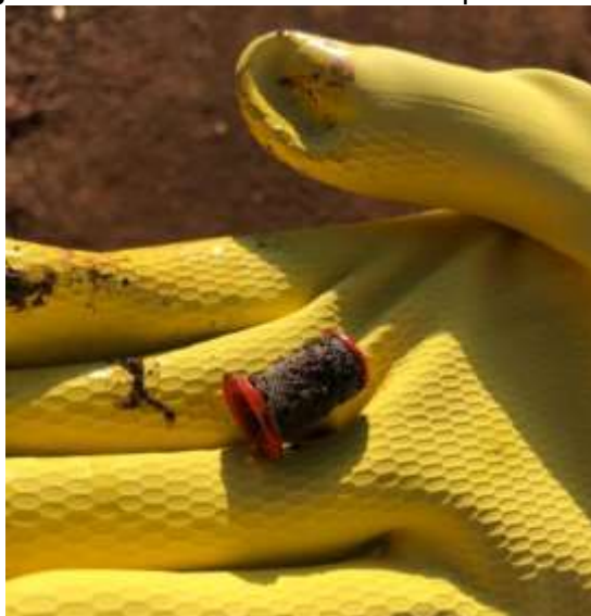
Figura 20 - Filtro do bico obstruído por resíduos.
