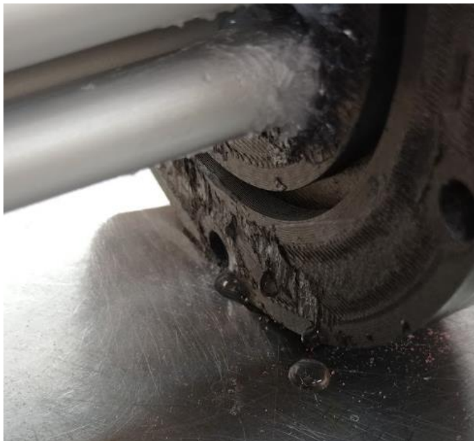
Figura 16 – Vazamentos através de falhas na impressão da flange.
