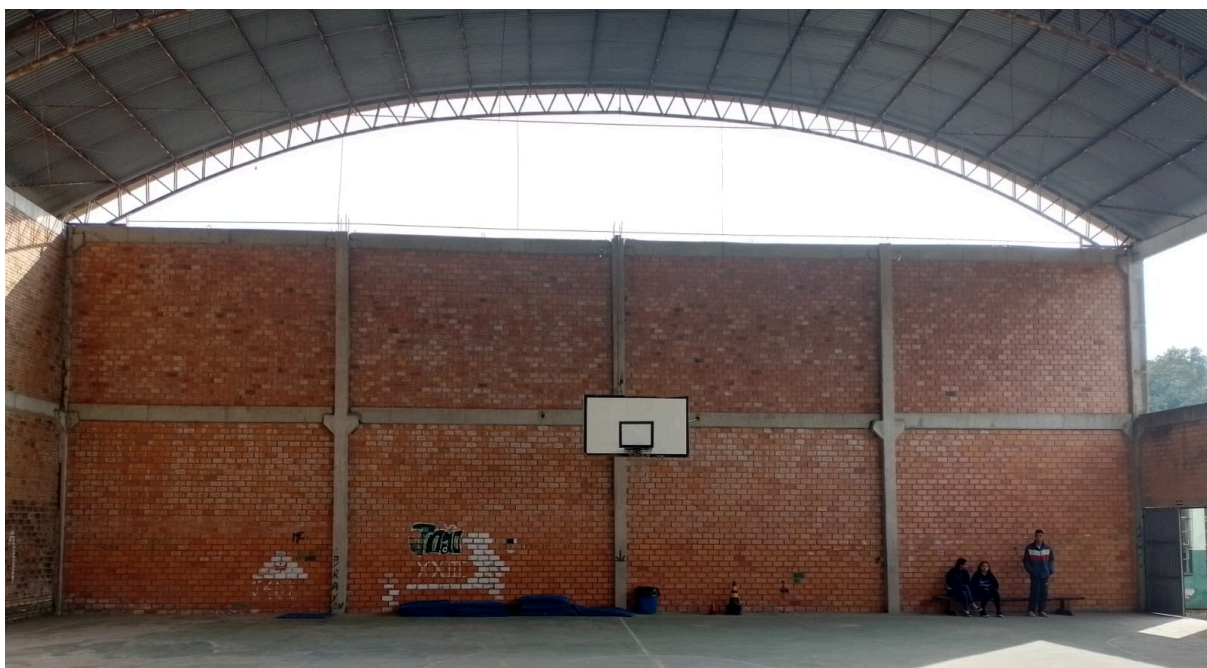
Figura 29 – Visão interna da parede do lado norte da quadra de esportes.
