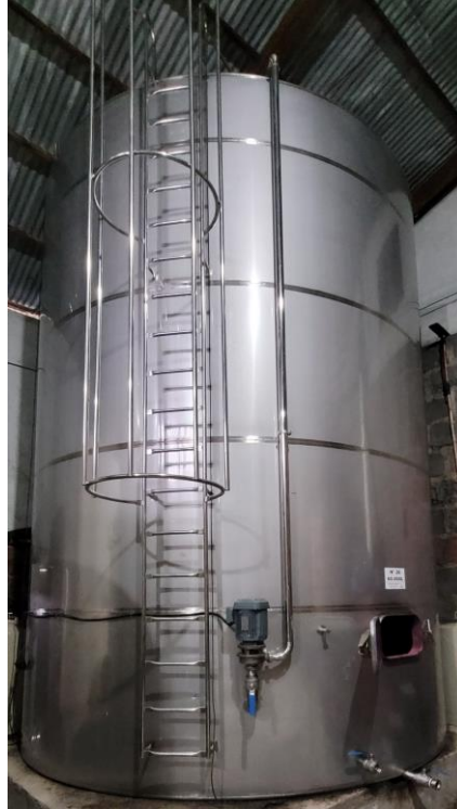
Figura 5: Tanque de fermentação
