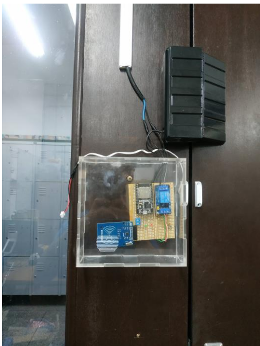
Fig. 15: Sistema instalado na sala 209A
