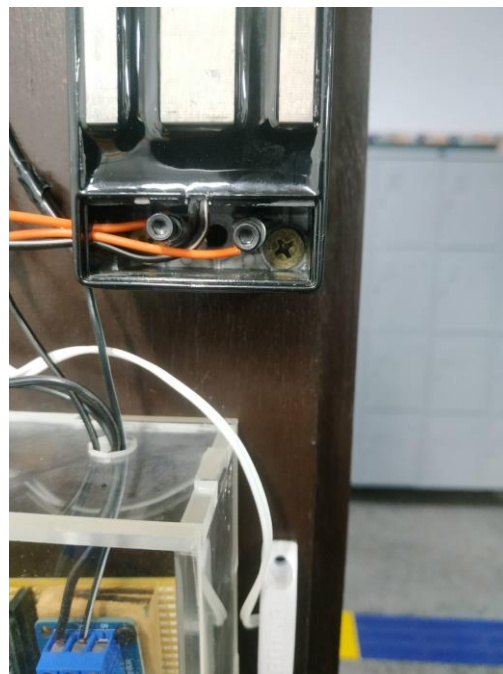
Fig.13: Alocação do sistema de sensoriamento
